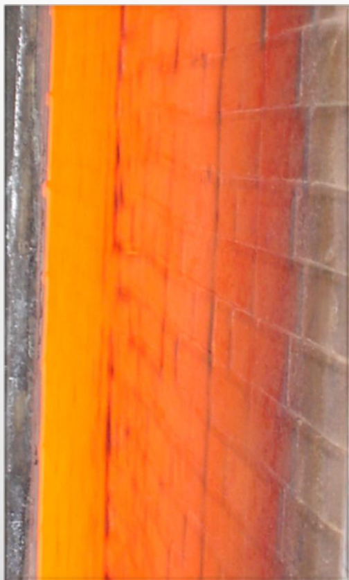
Uszkodzenia powierzchni ścian komory w obrębie skrajnych kanałów grzewczych do głębokości 20 mm
