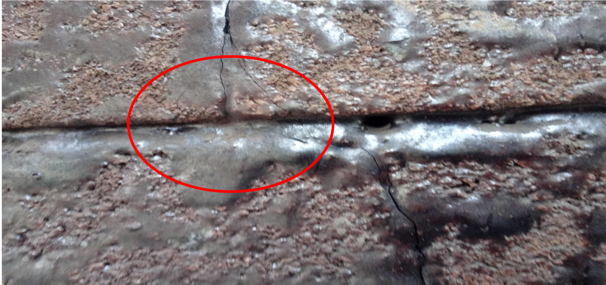
Widok fazy szklistej i wypełnienie fugi ściany grzewczej.
