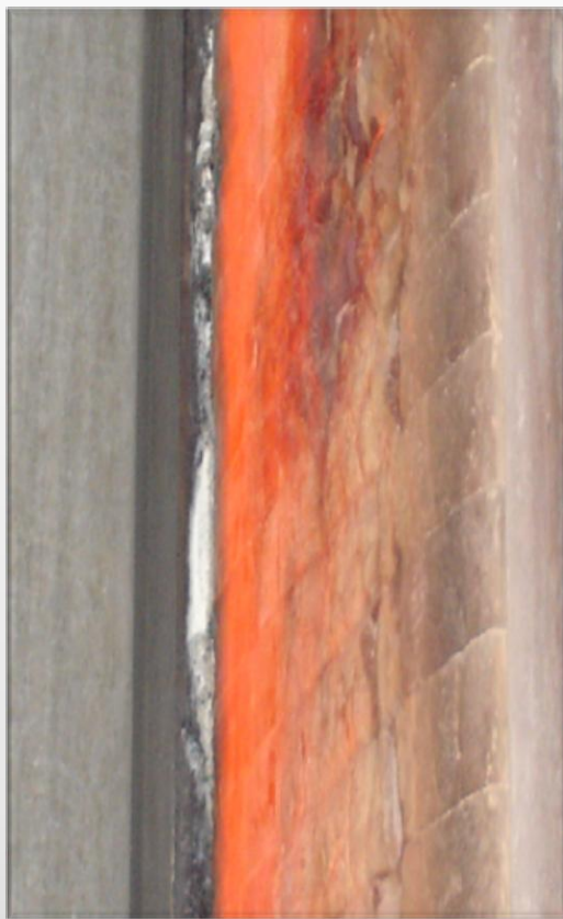
Uszkodzenia powierzchni ścian komory w obrębie skrajnych kanałów do głębokości 40 mm
