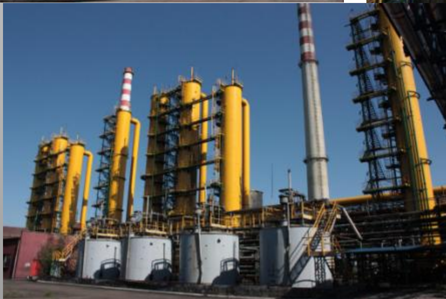
Instalacja oczyszczania gazu koksowniczego pod niskim ciśnieniem ( linia oczyszczania dla baterii 7-12) po roku 1997
